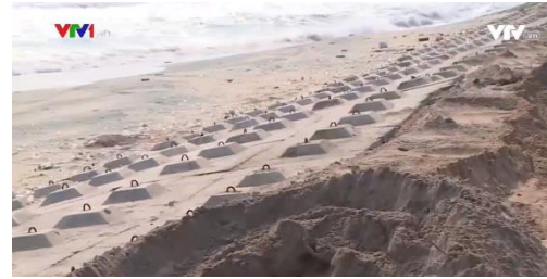
Hình 5. Đê biển Tư Hiền, Thừa Thiên Huế bị sự cố do đất đắp thân đê bị sóng, dòng chảy moi rỗng đang được sửa chữa
