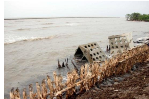
Hình 6. Sóng lớn trong trường hợp triều cường đã phá hủy công trình giảm sóng tại Cà Mau
