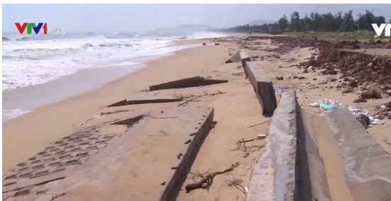
Hình 4. Đê biển ở Hoài Nhơn, Bình Định bị sự cố do lún làm nứt gãy dầm bê tông rách rời với mặt đê
