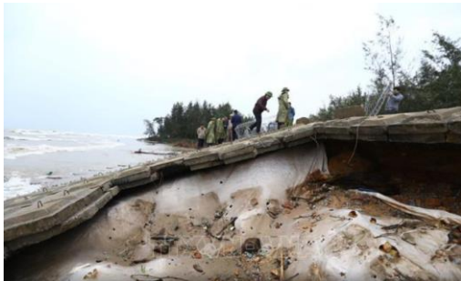
Hình 3. Đê biển mái nghiêng bằng đất tại Thịnh Lộc, Hà Tĩnh bị sự cố do lún làm tách rời kết cấu bảo vệ mặt và thân đê
