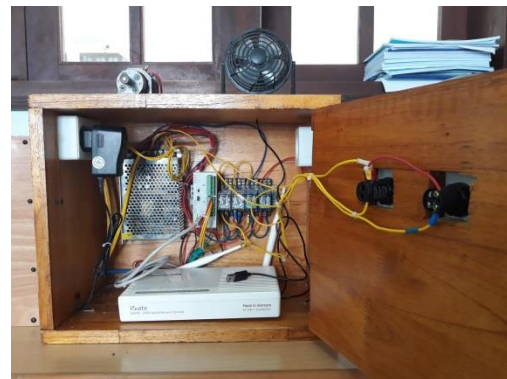
Hình 6. Bên trong tủ mô hình điều khiển sau khi hoàn thành
