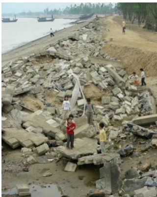
Hình 20. Kết cấu lớp bảo vệ mặt đê bị phá hủy do lún đất đắp lõi đê và nền
