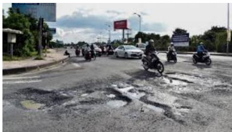
Hình 2. Hư hỏng kết cấu áo đường do mưa ngập (Nguồn Báo Pháp luật TP HCM)
