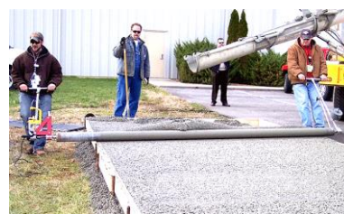
Hình 1. Hình ảnh sử dụng trồng lăn đầm và hoàn thiện bề mặt bê tông xi măng
